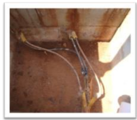
Caixa de passagem de energia abaixo do nível do piso
