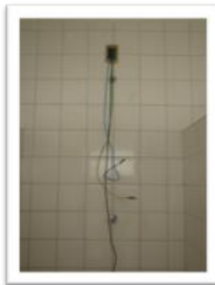
Instalações elétricas inacabadas
