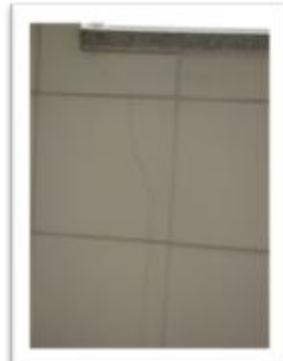
Trincas no revestimento
