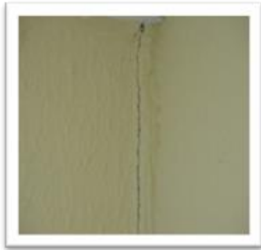
Rachaduras no canto da parede
