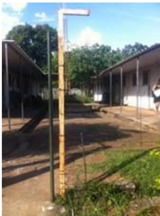
Cerca com arame farpado enferrujado ao lado do portão de acesso
